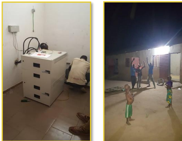
Imagen Izq. Batería BYD. Imagen Der. Luz de la instalación.
